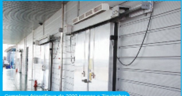
Complexe frigorifique de 2000 tonnes à Ziguinchor
